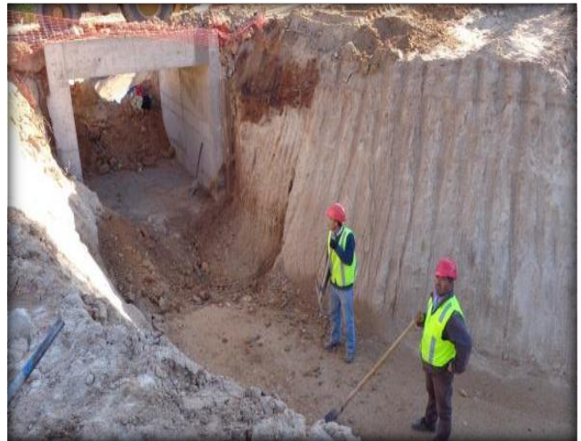
Cajones en paso predial, Km 26,380.
