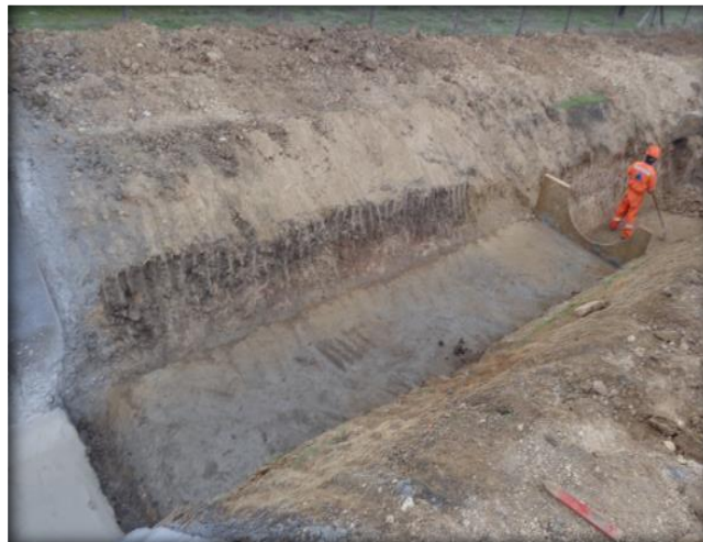
Caída vertical, Km 11,200.
