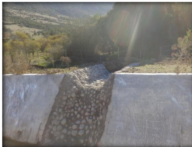
Descarga Tipo 1, Km 8,240.
